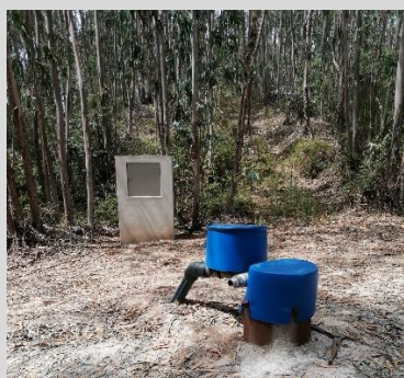
Captação subterrânea de água
